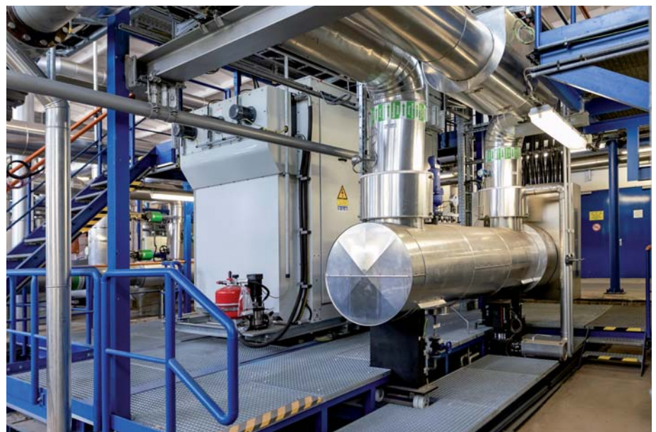
DIE MODERNE POWER-TO-HEAT-ANLAGE IM HEIZKRAFTWERK IN BERLIN-BUCH
